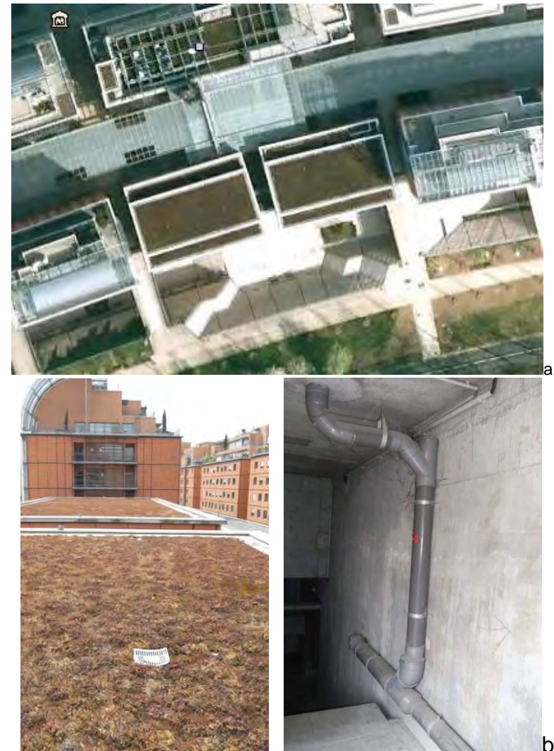
Figure 1, a : vue générale des toitures végétalisées (source Google Earth), b: vues de la toiture instrumentée et des conduites d'évacuation (photos N. Bergaud, RAEE).
